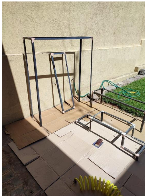
Fig. 12 Armazón metálico como soporte del sistema de filtración.
