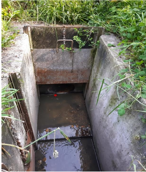
Imagen 17. Tanque de entrada de la PTAR. Fuente: Autora
