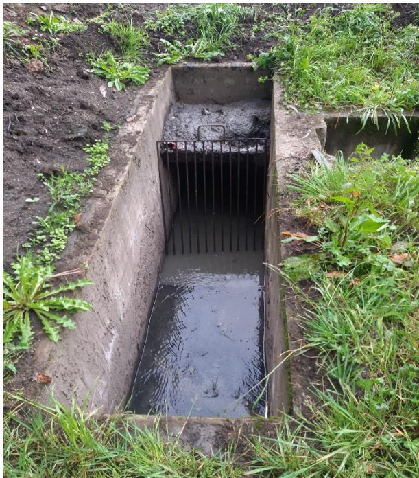
Imagen 19. Sistema de rejillas de la PTAR, rejilla mal colocada. Fuente: Autora
