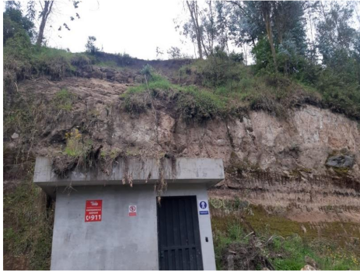
Imagen 27. Caseta de descanso con material producto de deslizamiento del talud inestable Fuente: Autora
