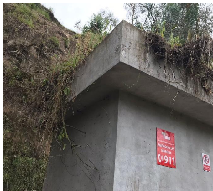
Imagen 5. Deslizamientos del talud sobre la infraestructura de la PTAR Fuente: Autora
