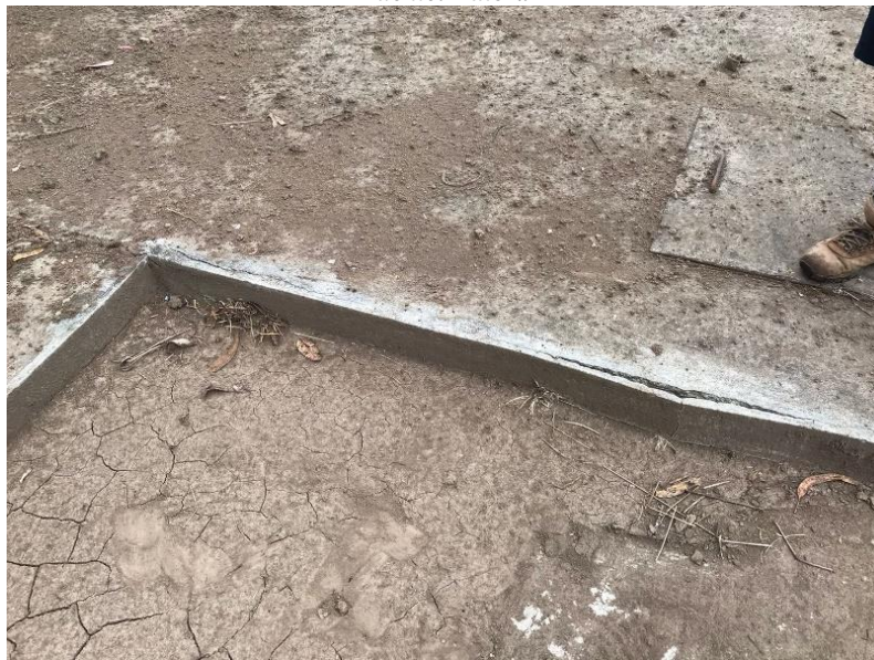
Imagen 23. Daño de enlucido del tanque séptico de la PTAR y presencia de lodo por desestabilización de talud. Fuente: Autora
