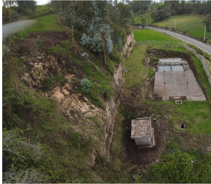
Imagen 6. Talud inestable en la PTAR.
