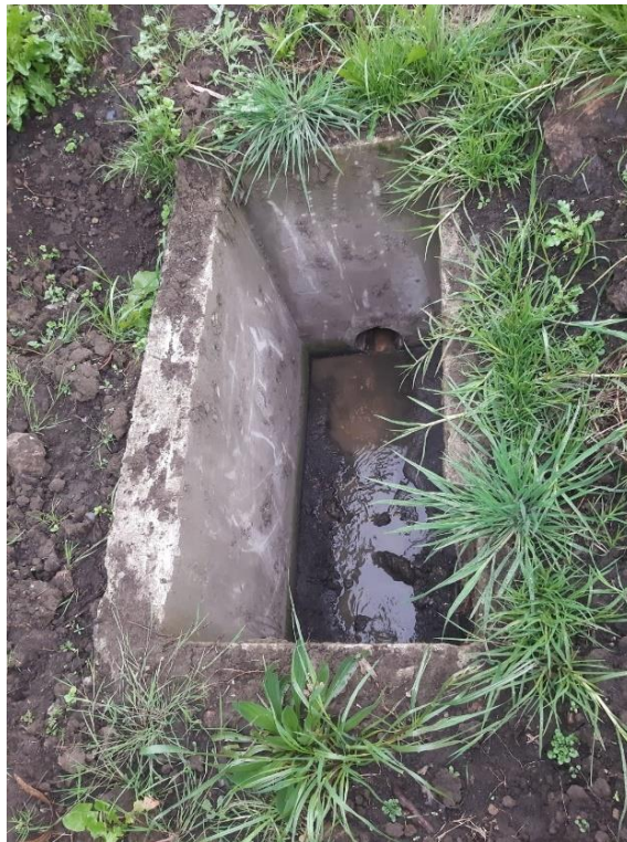
Imagen 21. Trampa de grasas después de la limpieza. Fuente: Autora
