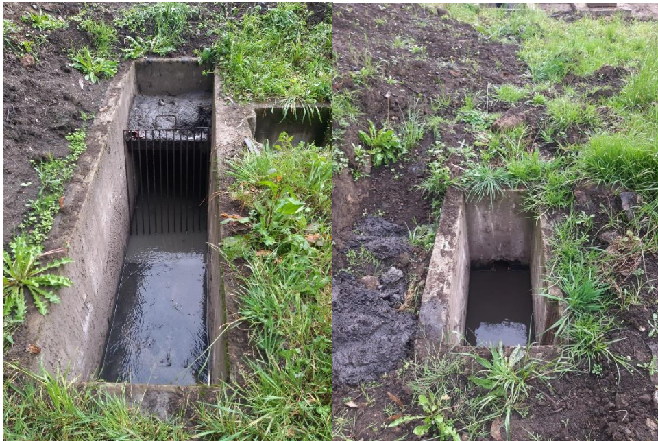
Imagen 30. Unidades de tratamiento de la PTAR con bordillo a nivel de terreno Fuente: Autora
