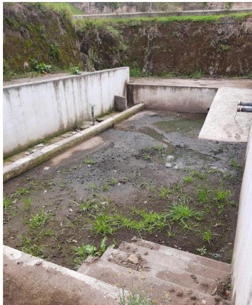
Imagen 35. Lecho de secado de lodos a la intemperie Fuente: Autora
