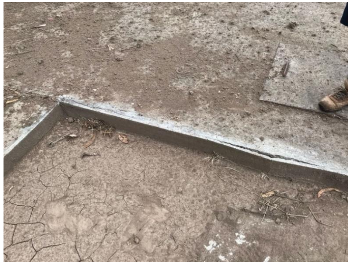
Imagen 28. Losa de tanque séptico con material del deslizamiento de suelo Fuente: Autora
