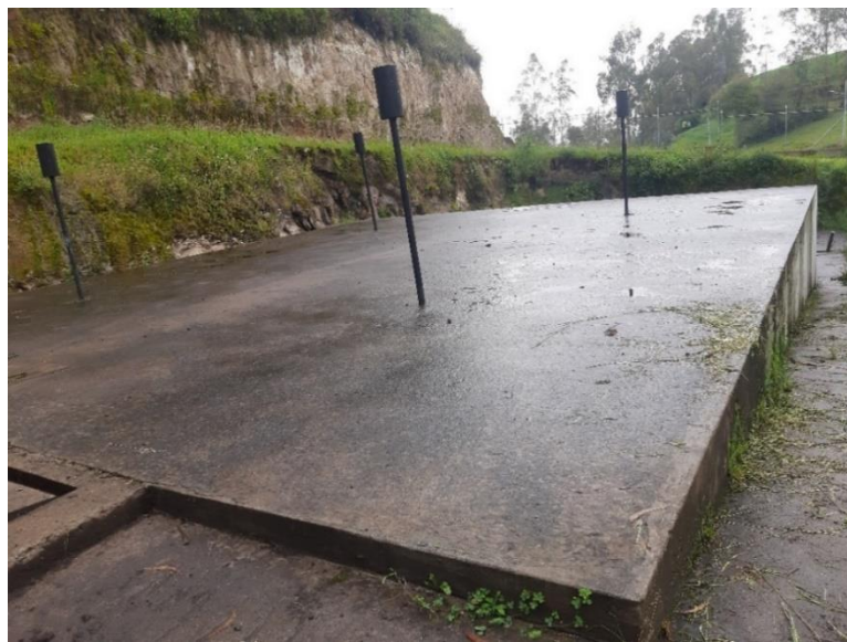
Imagen 22. Tanque séptico de la PTAR. Fuente: Autora
