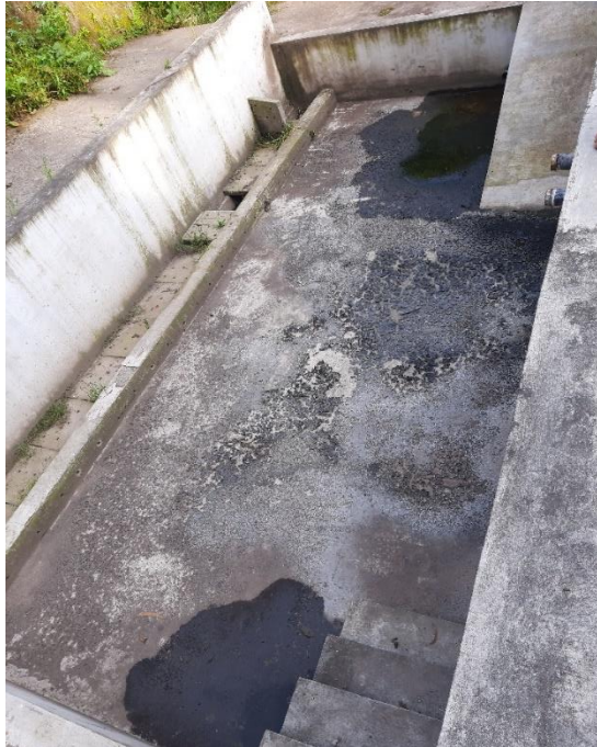
Imagen 25. Lecho de secado de lodos de la PTAR. Fuente: Autora
