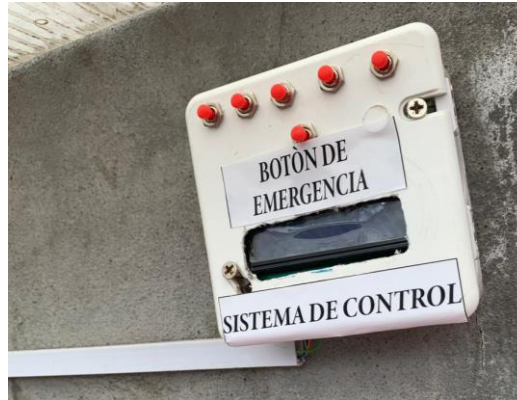
Figura 31: Tablero de control de sistema NFT
