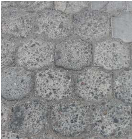
Gráfico 29. Falla por desgaste superficial, pavimento articulado.
