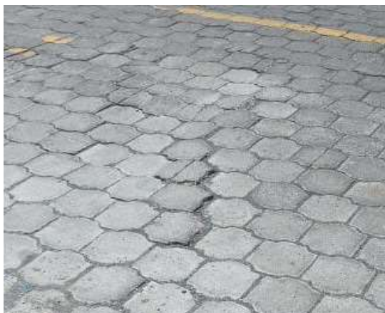
Gráfico 26. Falla por abultamiento, pavimento articulado.
