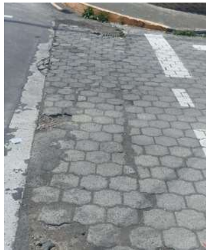
Gráfico 68. Falla por fracturamiento, pavimento articulado.
