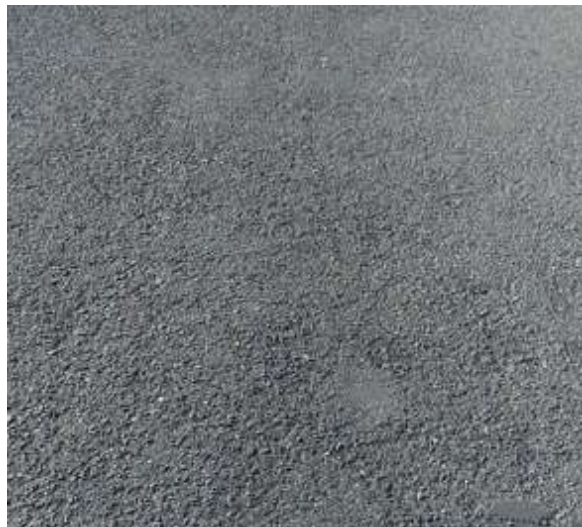
Gráfico 60. Falla por agregado pulido en la zona de estudio.
