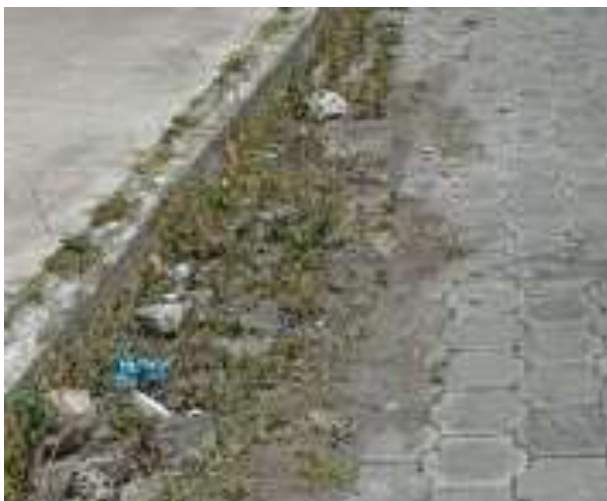
Gráfico 39. Falla por vegetación en la calzada.
