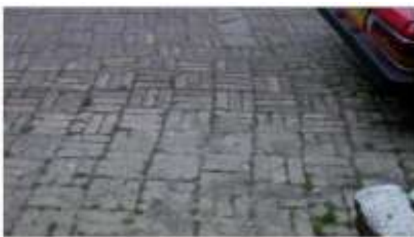
Gráfico 32. Falla por desplazamiento de juntas, pavimento articulado.
