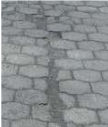
Gráfico 30. Falla por pérdida de arena, pavimento articulado.
