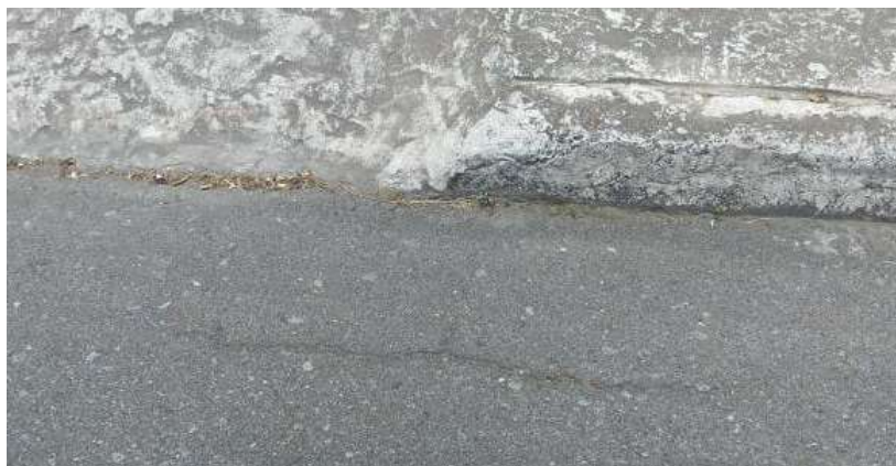
Gráfico 12. Falla por fisura de borde
