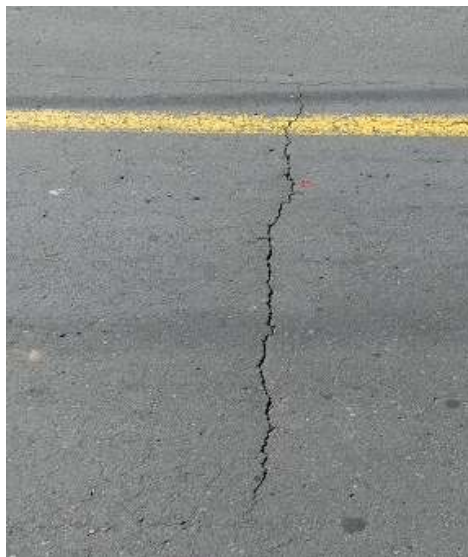
Gráfico 16. Falla por grieta transversal.
