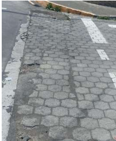
Gráfico 33. Falla por fracturamiento, pavimento articulado.
