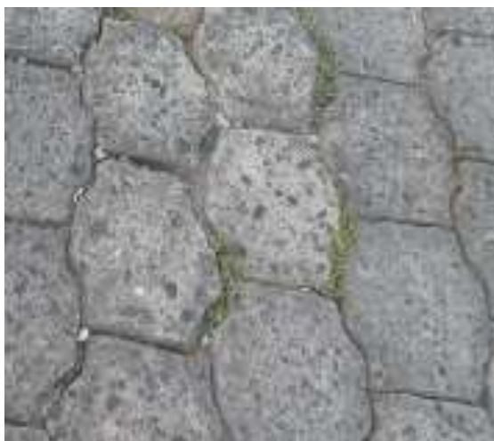
Gráfico 38. Falla por juntas abiertas, pavimento articulado.
