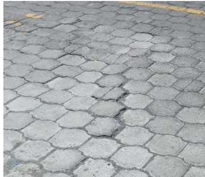
Gráfico 36. Falla por escalonamiento de adoquines
