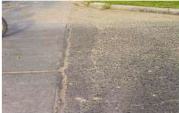
Gráfico 22. Falla por desplazamiento
