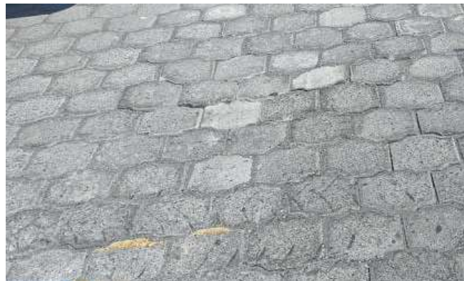
Gráfico 66. Falla por depresión, pavimento articulado.
