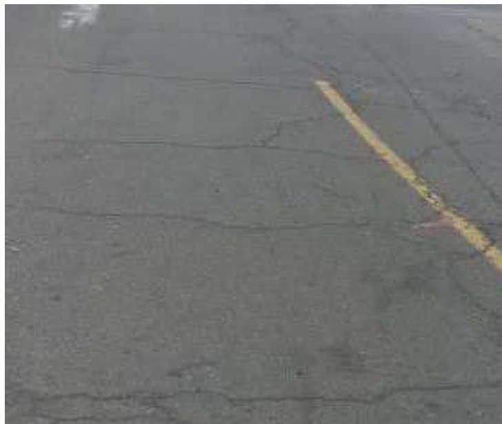
Gráfico 47. Falla por agrietamiento en bloque en la zona de estudio.
