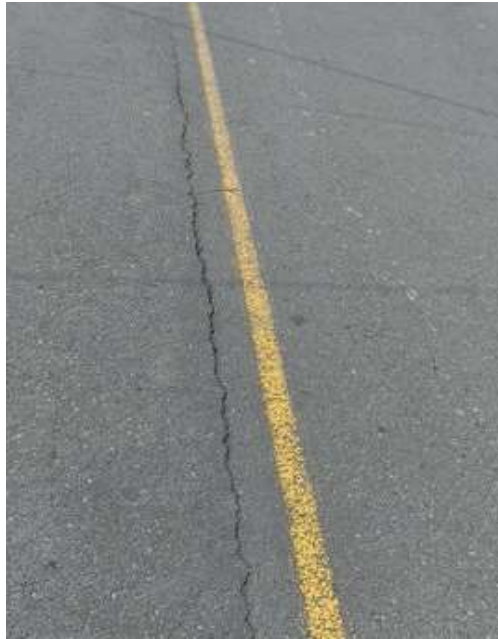
Gráfico 55. Falla por grieta longitudinal en la zona de estudio.
