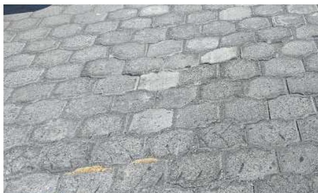
Gráfico 27. Falla por ahuellamiento, pavimento articulado.
