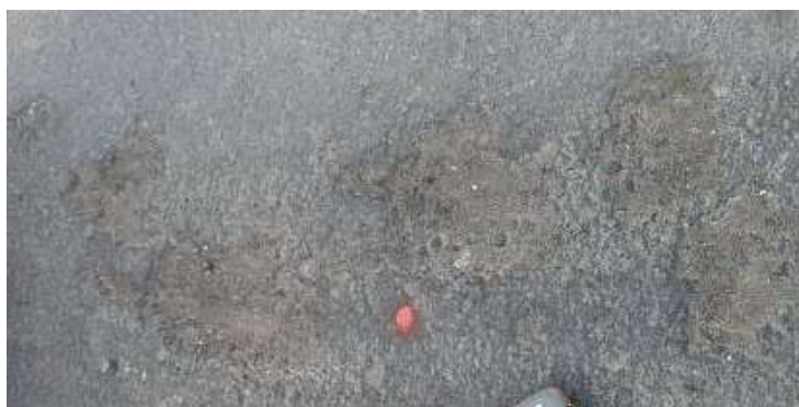
Gráfico 64. Falla por Desprendimiento de agregado en la zona de estudio.
