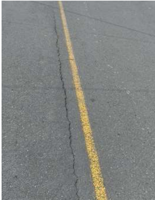
Gráfico 15. Falla por grieta longitudinal.
