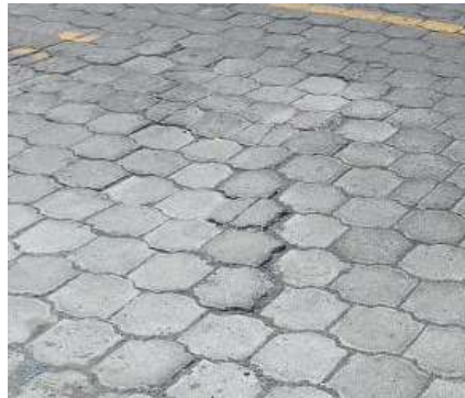
Gráfico 70. Falla por escalonamiento de adoquines, pavimento articulado.
