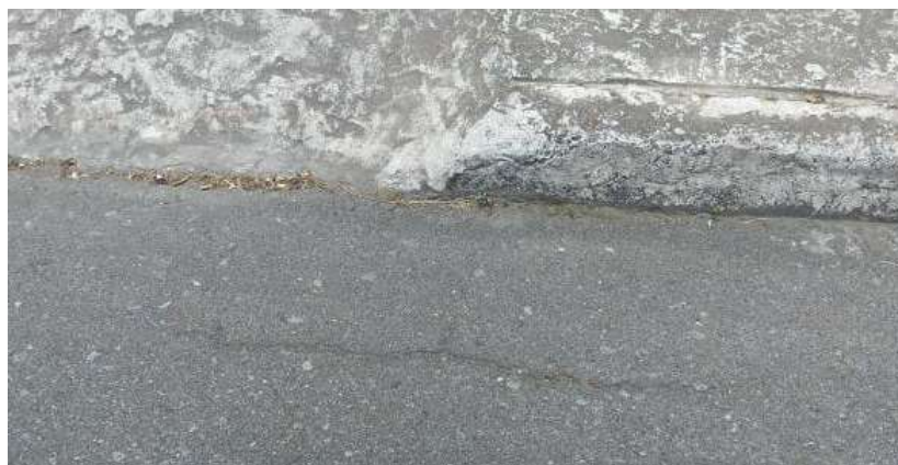
Gráfico 51. Falla por fisura de borde en la zona de estudio.
