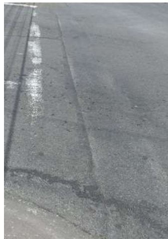
Gráfico 53. Falla por grieta de reflexión en junta en la zona de estudio.
