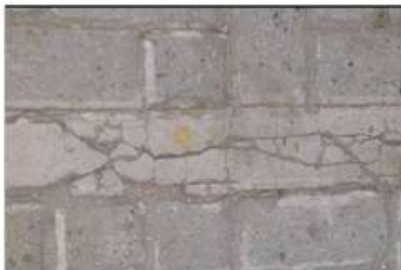
Gráfico 35. Falla por fracturamiento de confinamiento internos
