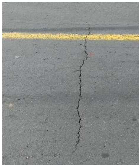
Gráfico 56. Falla por grieta transversal en la zona de estudio.
