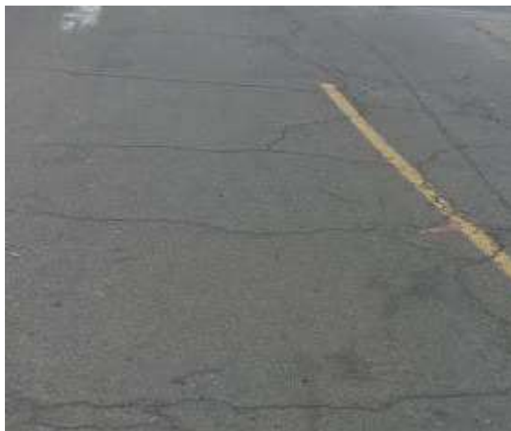
Gráfico 8. Falla por agrietamiento en bloque
