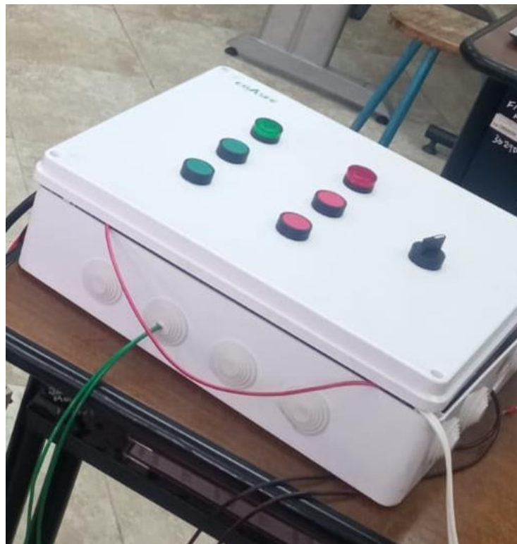
Figura 64. Sistema de control puesto en marcha.
