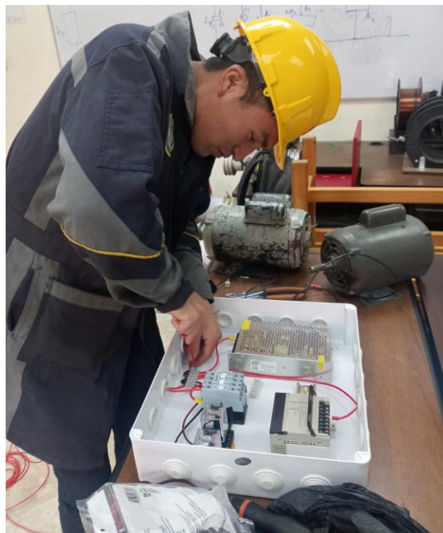
Figura 62. Sistema de control preensablada con contactor, fuente, relay y PLC.
