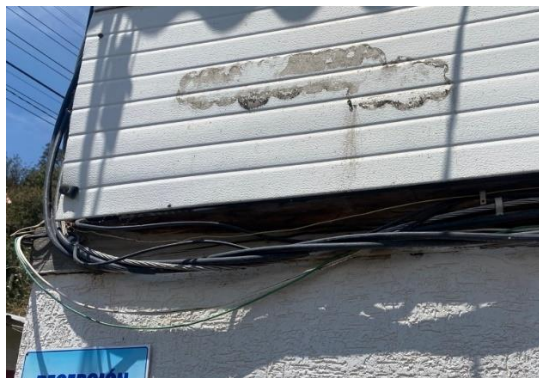
No se encuentran cortinas de PVC para evitar el ingreso de plagas
