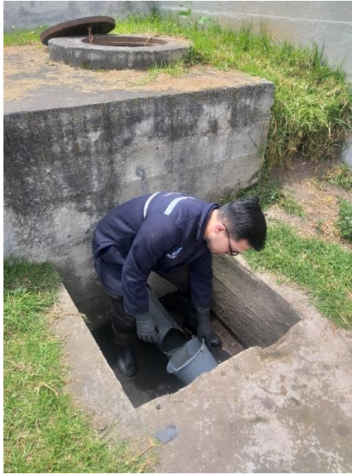
Figura 11. Medición de caudal de entrada
