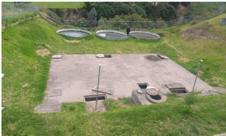
Figura 3. Componentes de la PTAR Fuente: Autor
