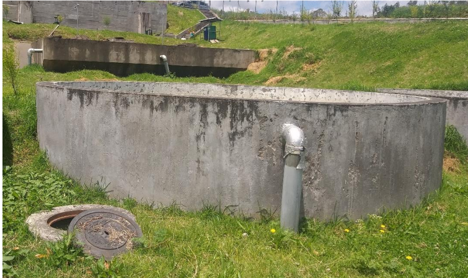
Figura 21. Filtro Anaeróbico de Flujo Ascendente 2
