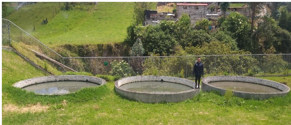
Figura 20. Filtros Anaeróbicos de Flujo Ascendente
