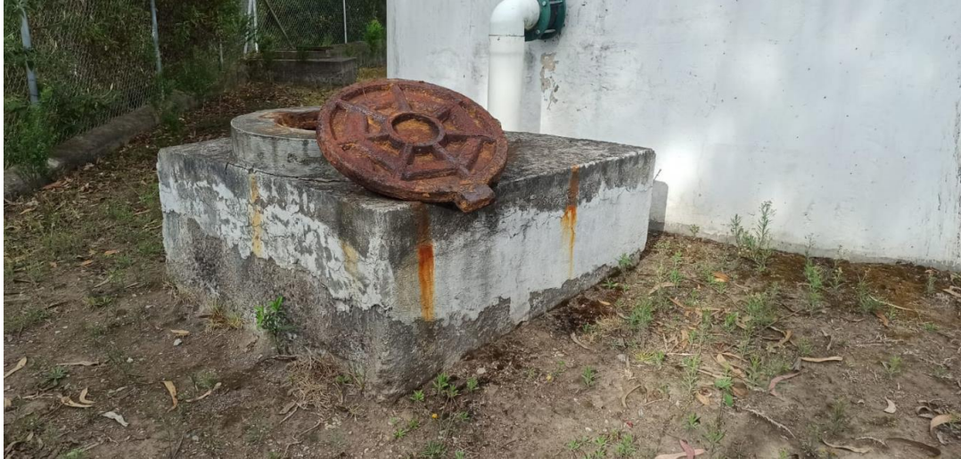
Figura 25 Tanque de Salida
