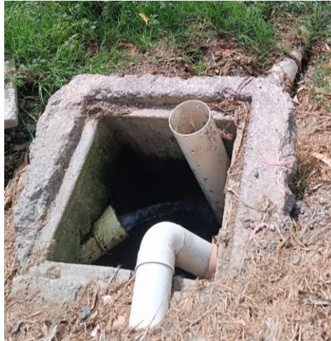
Figura 18: Pozo de salida del agua residual.
