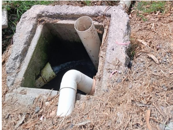
Figura 9: Fisuras y deterioro en el pozo de salida.
