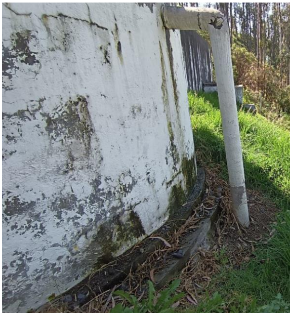
Figura 37: Estado actual de las paredes de la FAFA.
