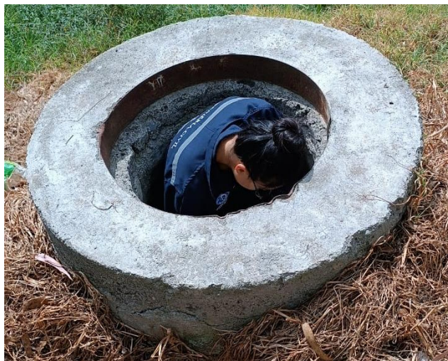
Figura 19: Medición del caudal de entrada de la PTAR Tres Esquinas.
