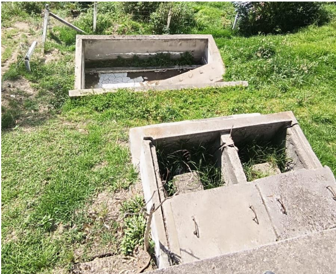
Figura 35: Estado de las dos válvulas que dirigen los lodos al lecho de secado.
