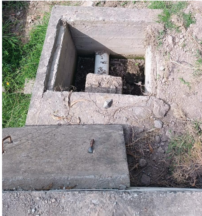
Figura 33: Estado de la válvula que sale del tanque repartidor de caudales.
