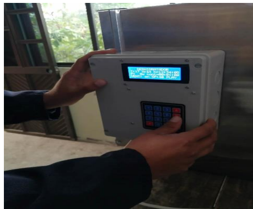
Figura 61. Tablero de control
