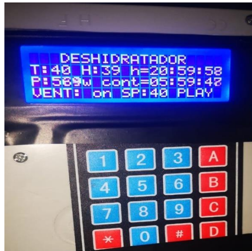
Figura 67. Panel de control para dar inicio al sistema de deshidratación
