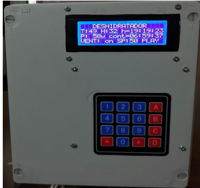
Figura 37. Tablero de control
