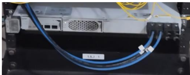
Figura 11 Huawei convertidor AC a DC (ETP48100-B1-50A)
