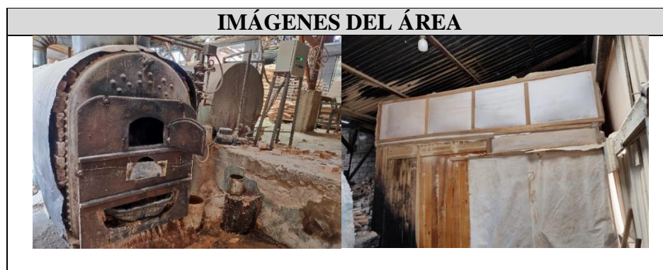
Fig. 32. Área de almacenamiento de residuos de procesos y caldera
