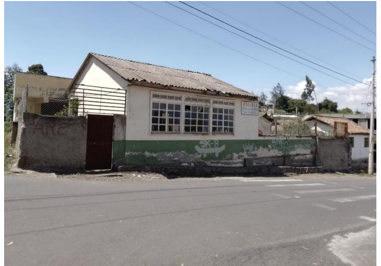
La escuela José Martínez se ubica en el caserío San Francisco actualmente se encuentra abandonada, no tiene ningún uso posterior a su cierre, consta de dos bloques de aulas el primero que es de bareque y una nueva construcción de losa. Cuenta con un bloque de baños
