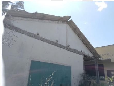
En parte de su cerramiento se puede apreciar que existe desprendimiento de la mampostería dejando así ver su estructura de caña guadua. Existe vestigios de un aula adicional debido a que en la parte exterior hay una pizarra
