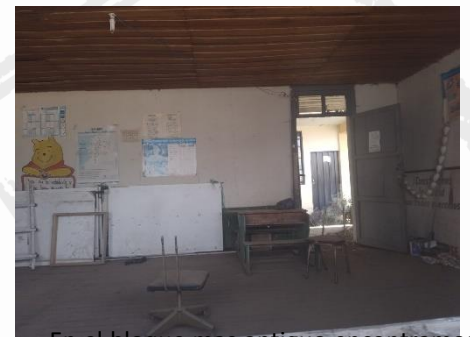
En el bloque más antiguo encontramos un deterioro en el piso y techo de duela de madera, de igual manera existen vidrios rotos, y desprendimiento de la mampostería
