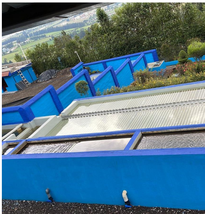
Figura 10. Planta de tratamiento de agua potable
