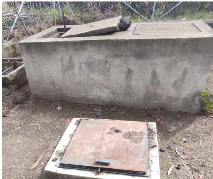
Figura 7. Cajón repartidor con rejilla de cribado Fuente: Alex Fernández
