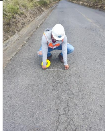
Medición de fallas
