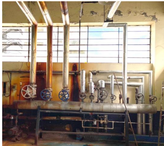
Figura 3.2. Distribuidor de vapor.
