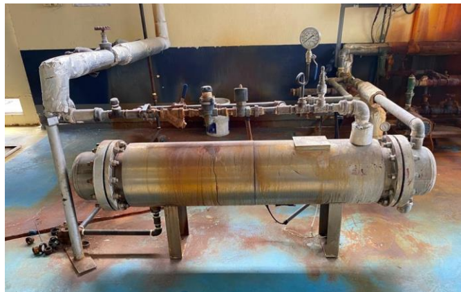
Figura 3.3. Intercambiador de calor del cuarto de máquinas.
