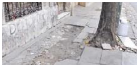
Figura 24. Se muestra la falla elementos faltantes
