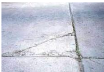
Figura 28. Se muestra la falla descascaramiento de esquina
