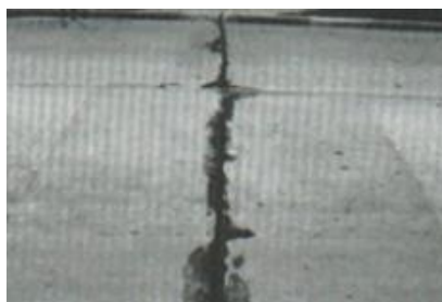
Figura 26. Se muestra la falla daño del sello de la junta
