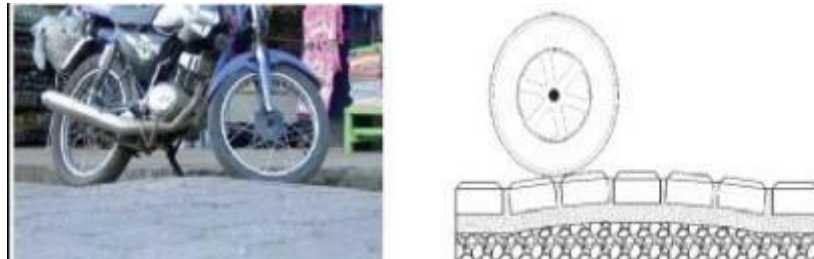
Figura 30. Se muestra la falla abultamiento
