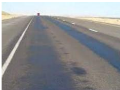
Figura 5. Se muestra la falla exudación
