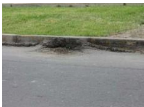
Figura 7. Se muestra la falla abultamiento
