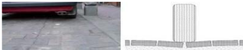
Figura 31. Se muestra la falla ahuellamiento
