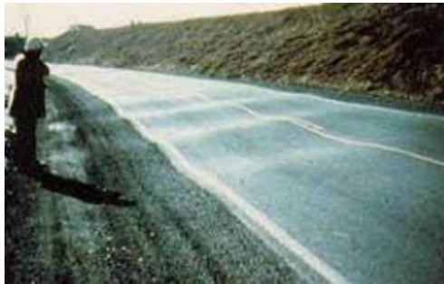
Figura 22. Se muestra la falla hinchamiento
