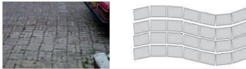
Figura 34. Se muestra la falla desplazamiento de juntas
