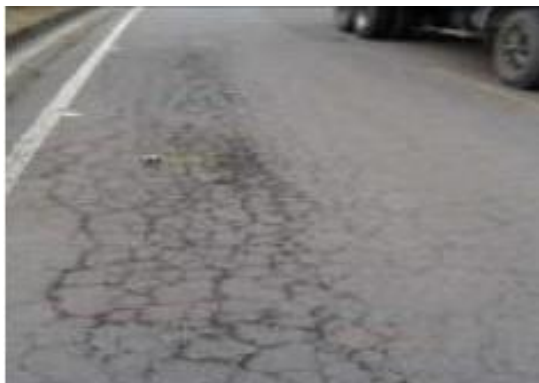
Figura 4. Se muestra la falla piel de cocodrilo
