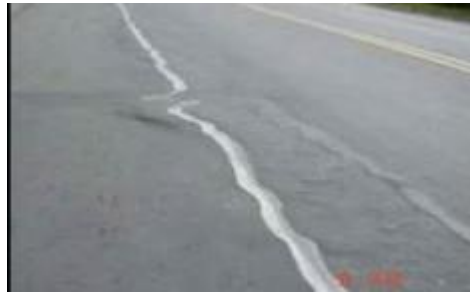
Figura 20. Se muestra la falla desplazamiento
