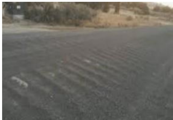
Figura 9. Se muestra la falla corrugacion
