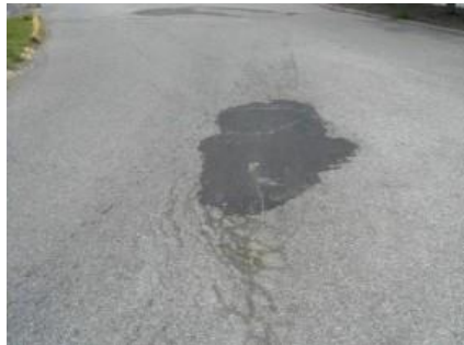
Figura 15. Se muestra la falla parqueo y acometidas de servicios públicos
