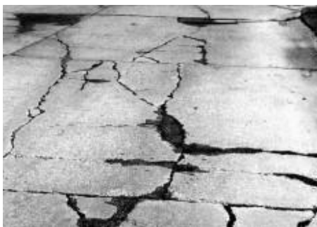
Figura 27. Se muestra la falla punzonamiento
