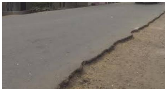
Figura 13. Se muestra la falla desnivel carril / berma
