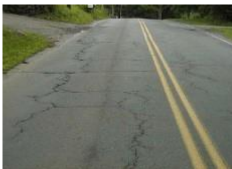
Figura 6. Se muestra la falla agrietamiento en bloque
