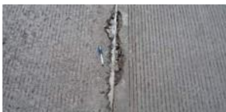
Figura 29. Se muestra la falla descascaramiento de junta
