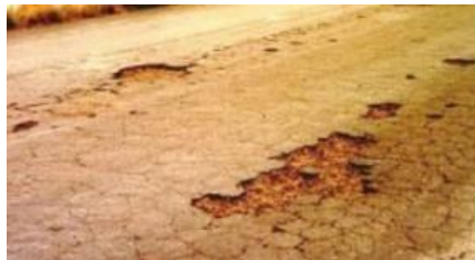
Figura 23. Se muestra la falla meteorización
