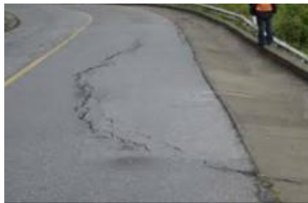
Figura 21. Se muestra la falla grietas parabólicas
