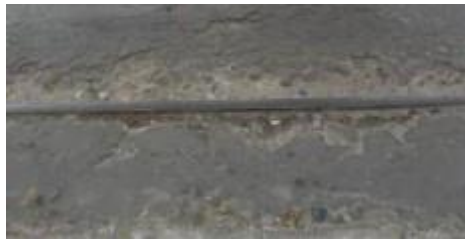
Figura 18. Se muestra la falla cruce de vía férrea
