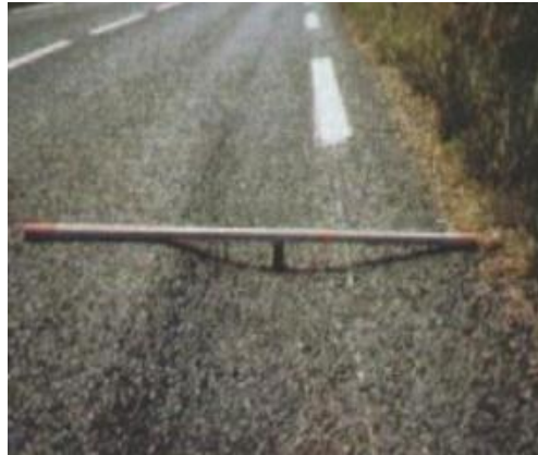
Figura 10. Se muestra la falla depresión
