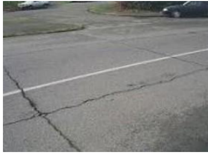
Figura 12. Se muestra la falla grieta de reflexión de junta
