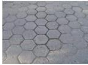
Figura 36. Se muestra la falla juntas abiertas
