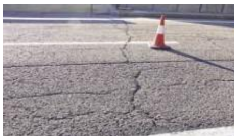
Figura 14. Se muestra la falla grietas longitudinales y transversales
