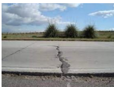
Figura 25. Se muestra la falla losas divididas
