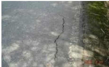
Figura 11. Se muestra la falla grieta de borde
