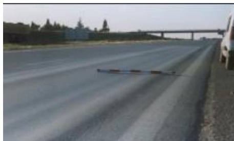
Figura 19. Se muestra la falla ahuellamiento
