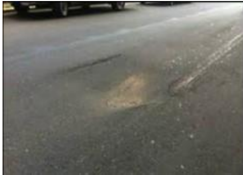
Figura 8. Se muestra la falla hundimiento
