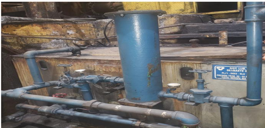
Figura 8 Falta de mantenimiento en las centrales.
