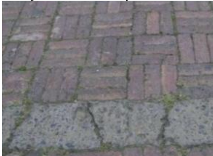
Fig. 48. Fracturamiento de confinamientos internos
