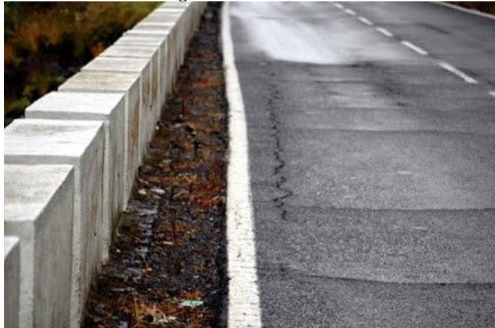
Fig. 12. Grieta de borde
