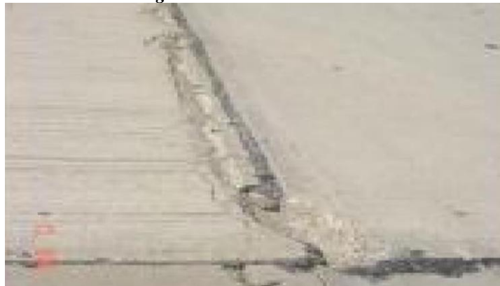
Fig. 37. Saltaduras en la Junta
