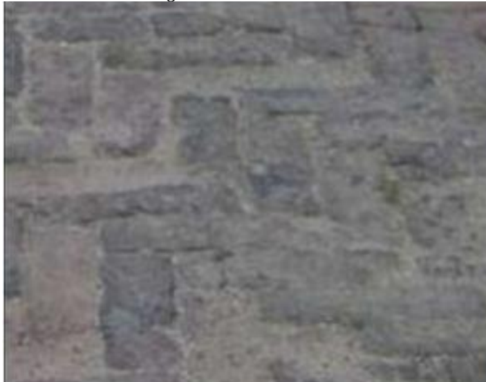
Fig. 43. Pérdida de arena
