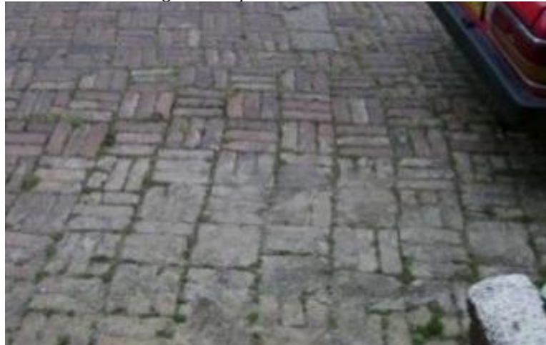
Fig. 45. Desplazamiento de Juntas
