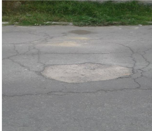
Fig. 9. Abultamiento y hundimiento
