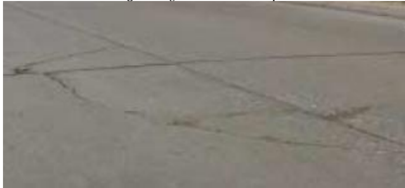
Fig. 33. Agrietamiento de Esquina
