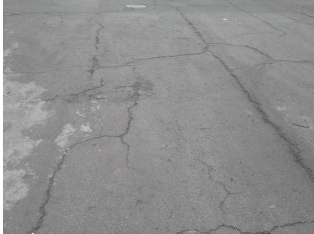
Fig. 8. Agrietamiento en bloque
