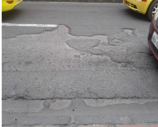
Fig. 13. Grietas de reflexión de juntas
