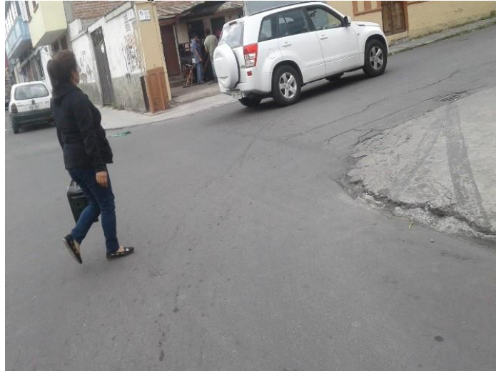
Fig. 14. Desnivel Carril / Berma
