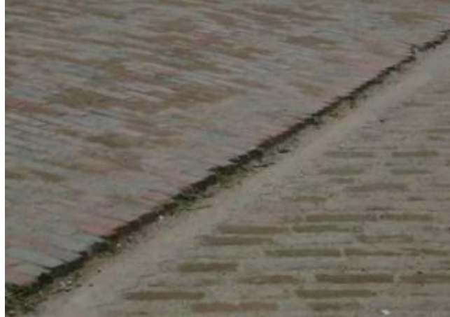
Fig. 50. Escalonamiento entre adoquines y confinamientos
