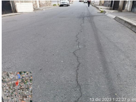
Ilustración 23. Grietas Longitudinales y Transversales.
