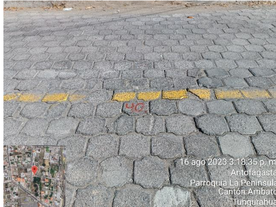
Ilustración 33. Abultamiento en pavimento Articulado de la Zona 10
