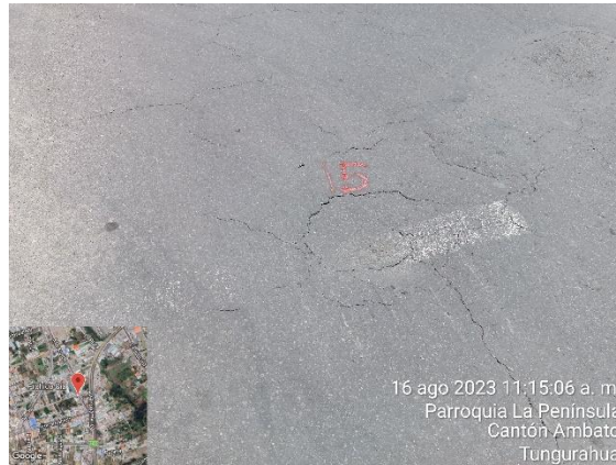
Ilustración 19. Falla de tipo depresión
