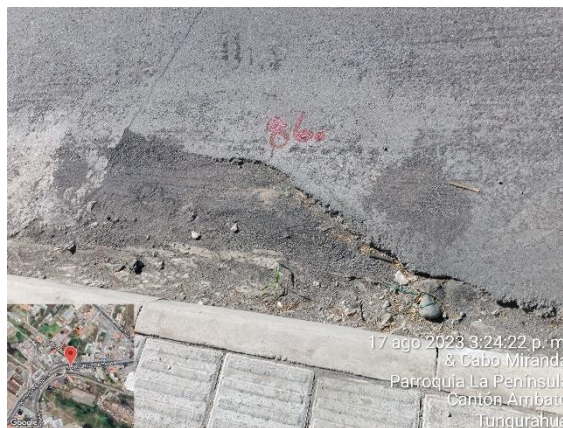
Ilustración 21. Grieta de Borde
