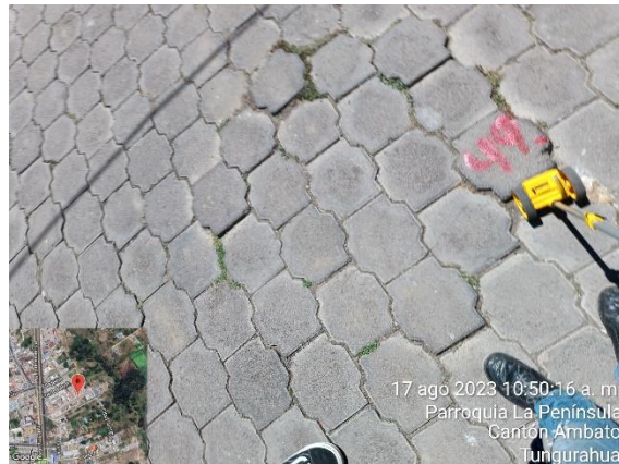
Ilustración 35. Depresión en Pavimento articulado de la Zona 10
