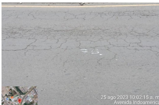
Ilustración 15. Piel de Cocodrilo en Pavimento Flexible Zona 10
