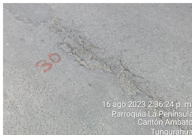
Ilustración 29. Desprendimiento de Agregados
