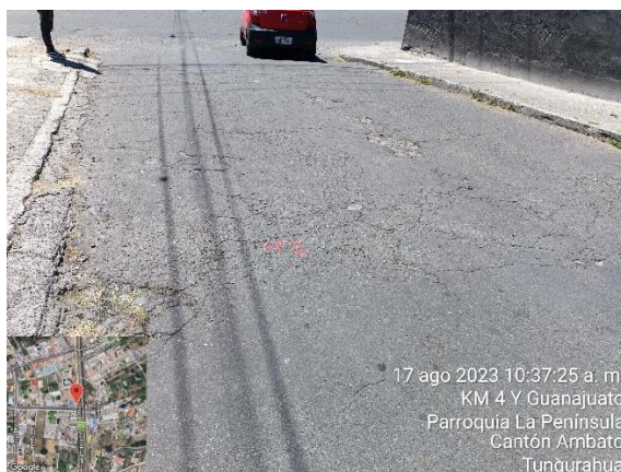
Ilustración 17. Falla de tipo agrietamiento en bloque.
