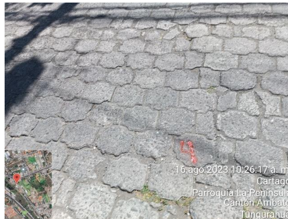
Ilustración 37. Fracturamiento en Pavimento Articulado de la Zona 10
