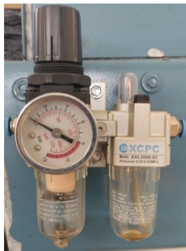
Figura 12: Unidad de mantenimiento del sistema neumático.
