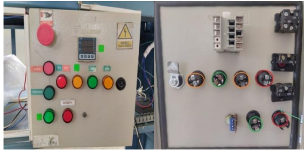
Figura 16: Luces piloto ubicadas en el panel de control.
