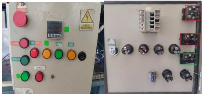
Figura 17: Pulsadores ubicadas en el panel de control.
