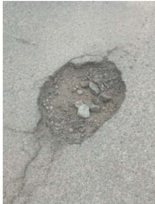
Falla tipo hueco
