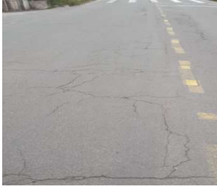
Figura 1: Falla registrada en la vía Pelileo - Guayaquil Autoría Propia
