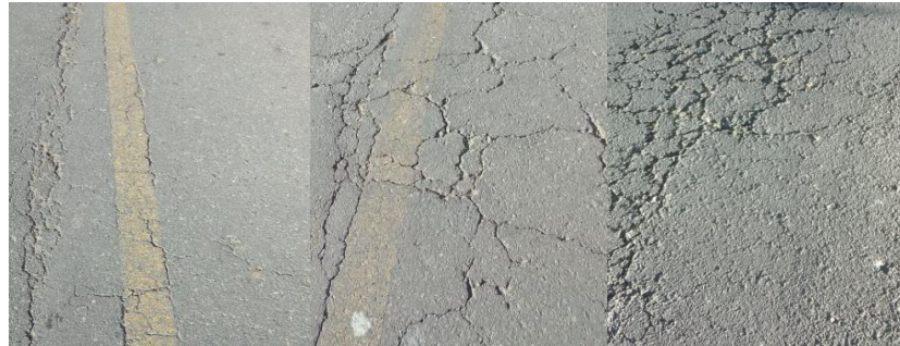
Figura 2. Deformaciones en la estructura del pavimento
