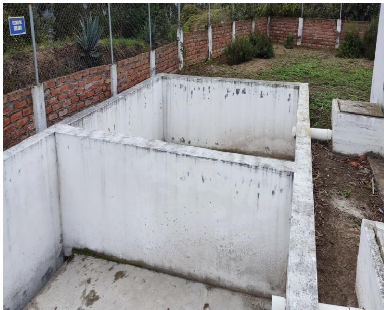
Figura 10. Unidad de tratamiento lecho de secado de lodos.
