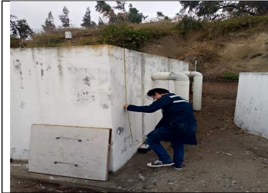
Unidad de tratamiento fosa séptica.
