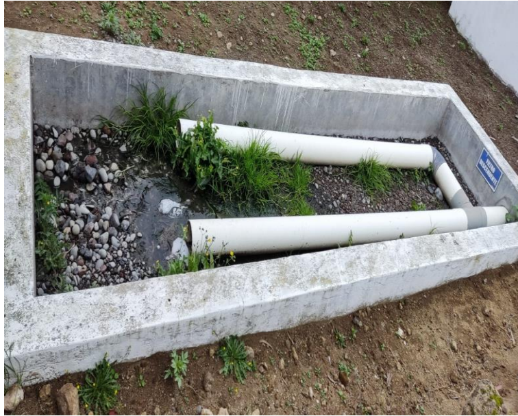
Figura 40. Filtro percolador durante la inspección.
