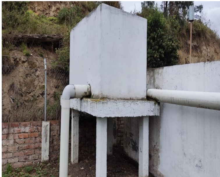
Figura 6. Unidad de tratamiento desarenador.
