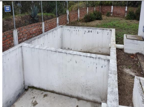
Unidad de tratamiento lecho de sedos de lodos.
