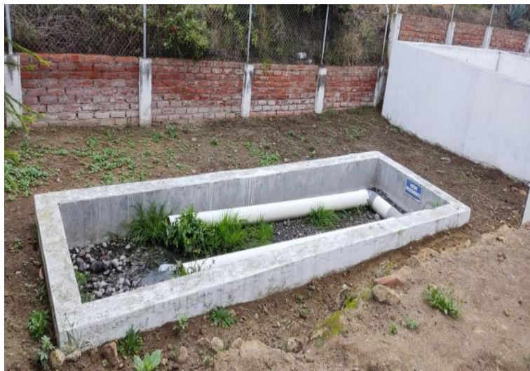
Figura 9. Unidad de tratamiento filtro percolador.
