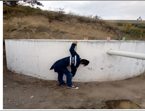
Unidad de tratamiento filtro anaerobio de flujo ascendente.
