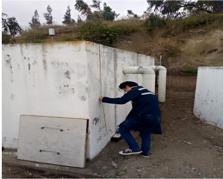
Figura 7. Unidad de tratamiento fosa séptica.
