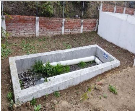
Unidad de tratamiento filtro percolador.
