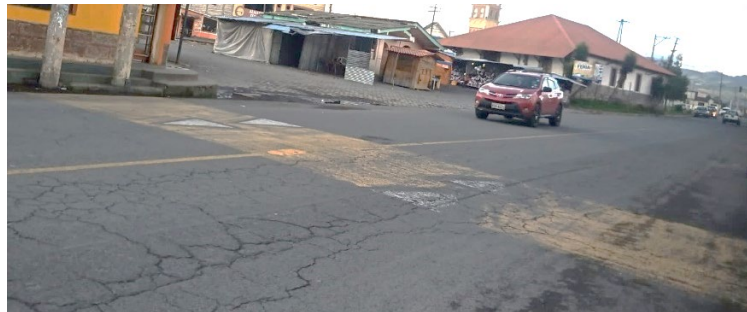
Gráfico 22: Señalización de resalto deteriorada ABS 2+440
