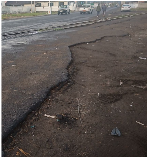
Gráfico 16: Falla Grieta de Borde
