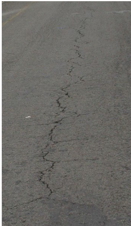
Gráfico 17: Falla grieta longitudinal y/o transversal
