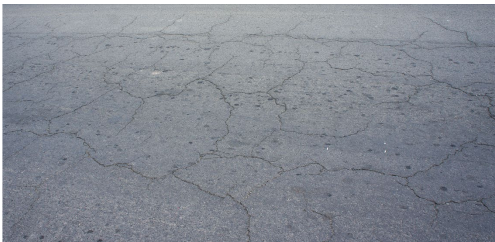
Gráfico 15: Falla agrietamiento en bloque
