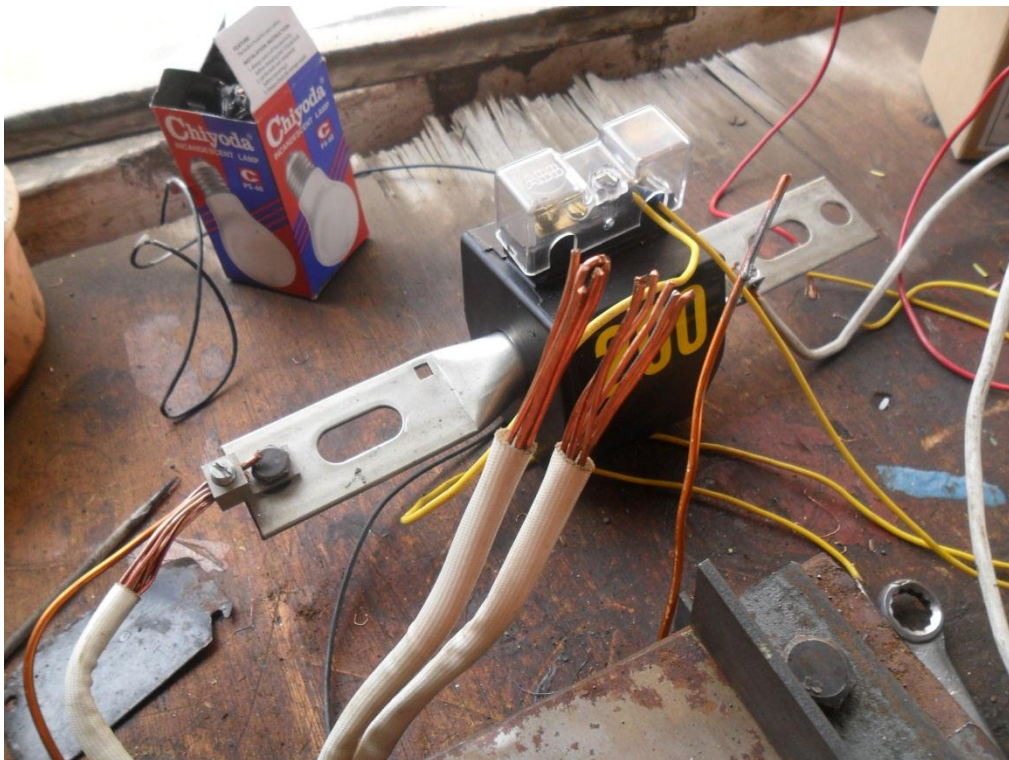
Foto N°06: Alimentación para el fusible
