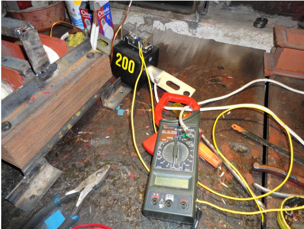
Foto N°03: Verificación de corriente
