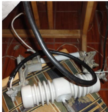
Foto N. 30: Alimentación del seccionador (*)
