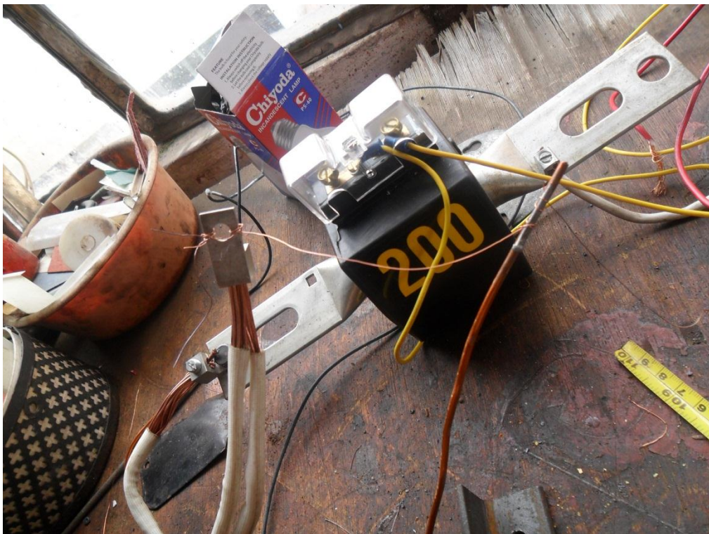
Foto N°08: Conexión del transformador de corriente
