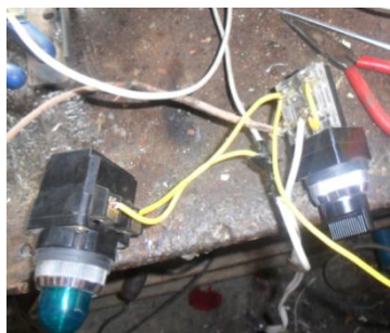
Foto N. 17: Conexión entre el selector y luz piloto (*)
