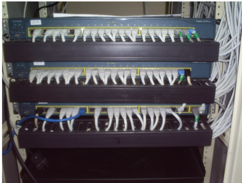
Switchs ubicados en el Rack 2
