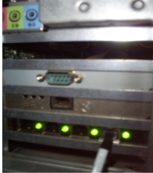
Figura 6.44: Tarjeta OpenVox colocada en el Servidor
