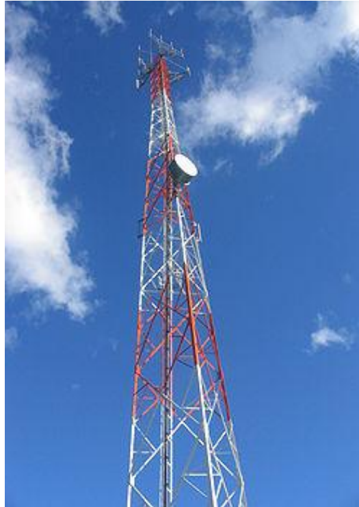
Figura 6.11. Repetidora de señales
