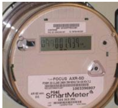
Figura 6.6. Medidor Eléctrico digital SmartMeter
