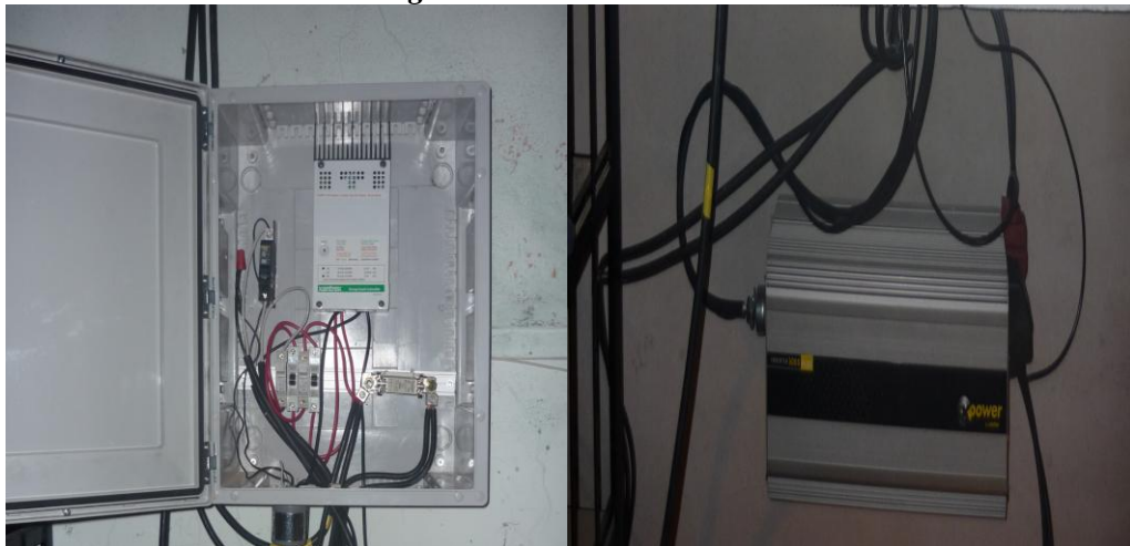
Figura 6.22 Regulador de carga y convertidor.
