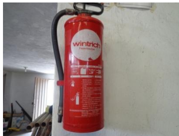
Figura 62: Extintor contra incendio Elaborado por: La investigadora
