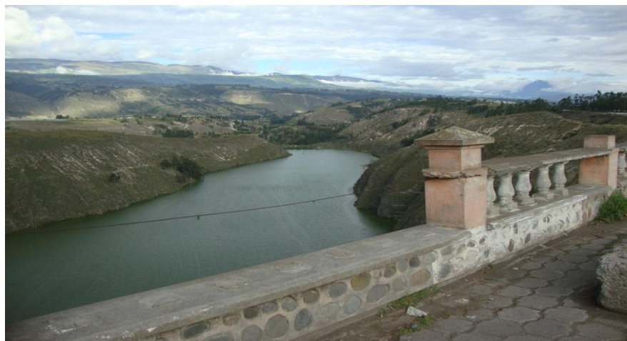
Foto N° 03 Mirador de la Laguna en mal estado
