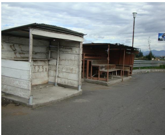
Foto N° 01 Tiendas en mal Estado
