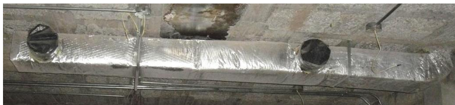
Figura 4.3. Ducto de suministro de la Sala de Recuperación
