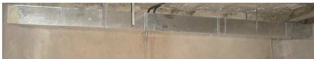
Figura 4.2. Ducto de retorno del Quirófano
