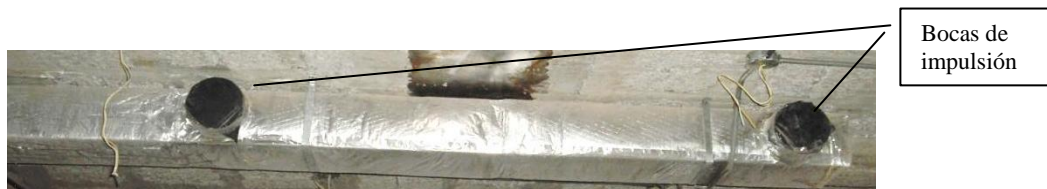
Figura 4.1. Ducto de suministro del Quirófano
