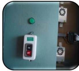
Fig. 6-49. Pulsador de encendido del tablero de control del Router CNC
