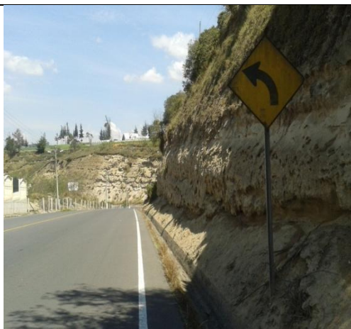
(3+600) CURVA A LA IZQUIERDA (MAL ESTADO)
