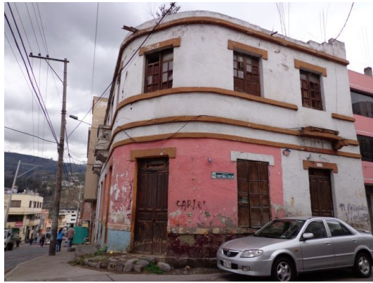
Calle Colón y Aillón, la casa se encuentra afectada, por lo que no existe acera completa.
