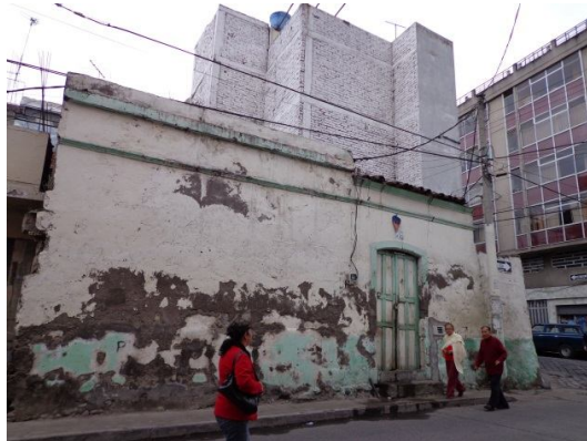
Calle Colón cerramiento afectado, no existe acera completa.
