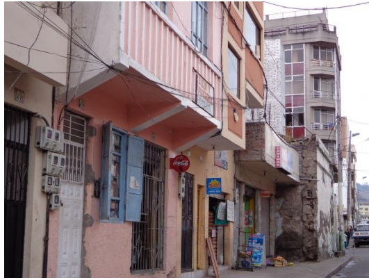
El cerramiento afectado que consta en la foto anterior, visto desde otro ángulo.
