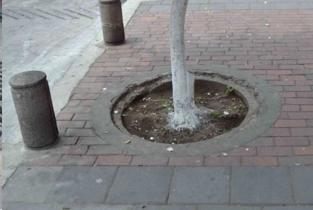
Fig16. Alcorque sin protección Calle Sucre.
