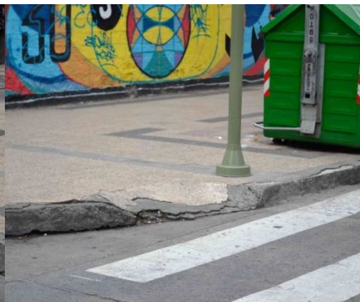
Fig23. Rampa en mal estado Calle Sucre.
