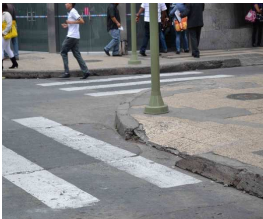
Fig 22. Rampa en mal estado Calle Sucre .
