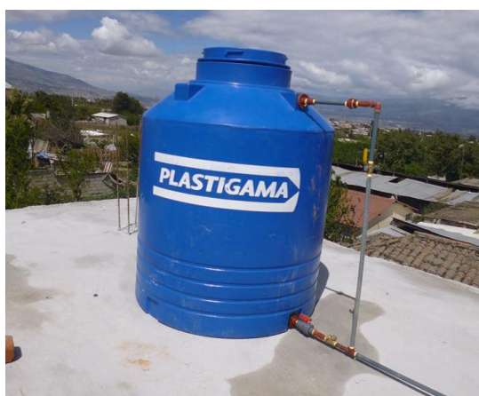
Fotografía N°1. Forma de almacenamiento seguro del agua potable
