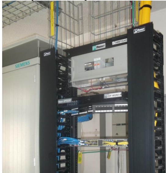
Router y conversor óptico-eléctrico
