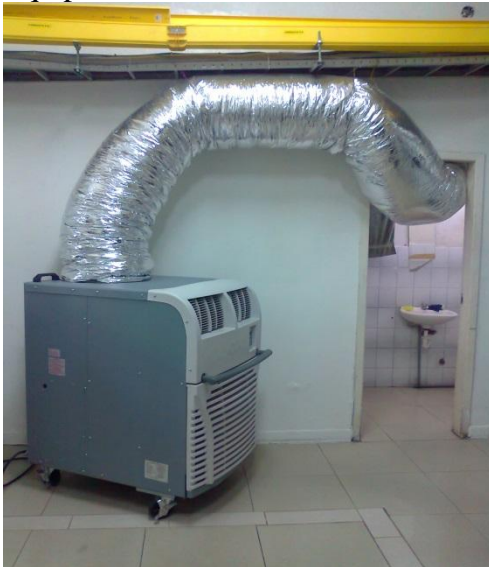
Equipo de climatización
