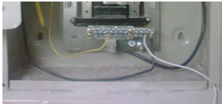
Figura 51: Conexión del neutro obtenido de las cajas de distribución.
