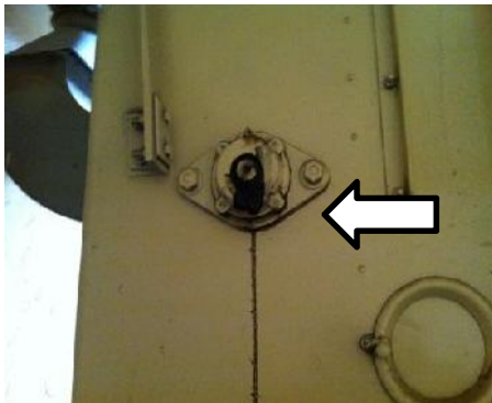
Imagen 23. Antes, Exceso de Grasa No alimentario en algunos equipos
