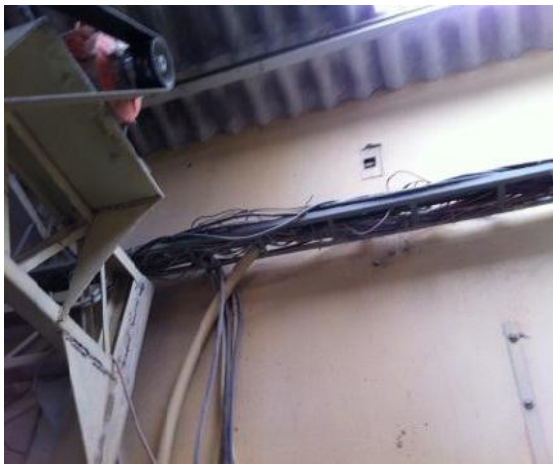
Imagen 11. Antes, redes eléctricas desordenadas
