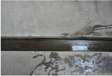
Imagen 11. Antes, Sin rejilla en sistemas de agua
