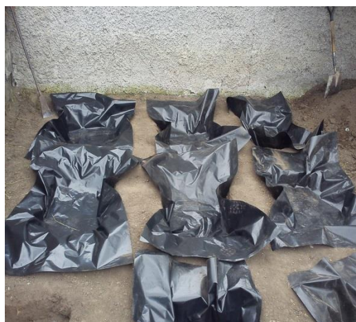
Fotografía C-3.- Geomembrana para evitar lixiviación
