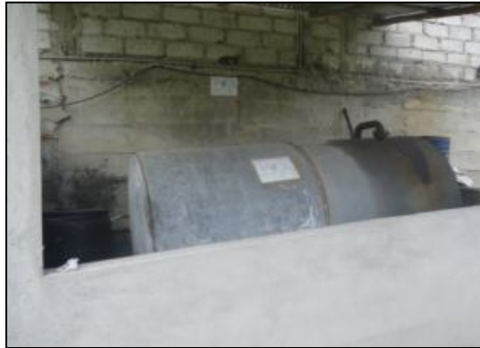
Anexo G.8. Tanque de Combustible Fuente: TEX-MODA
