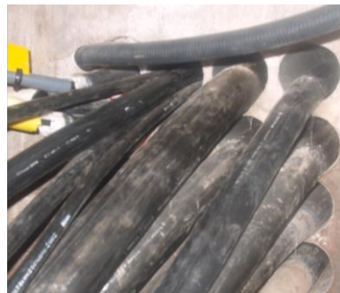
Figura 16: Ductos congestionados en el centro de la ciudad de Ambato
