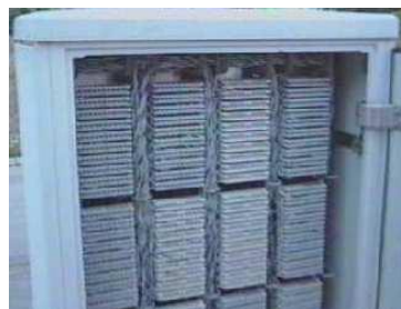
Figura 12: Estructura Física de un armario con las regletas
