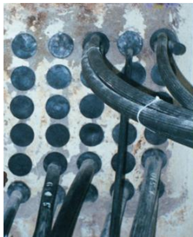
Figura 14: Ductos en las cámaras telefónicas
