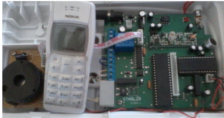
Fig 4.28. Bloque Controladora del Sistema.
