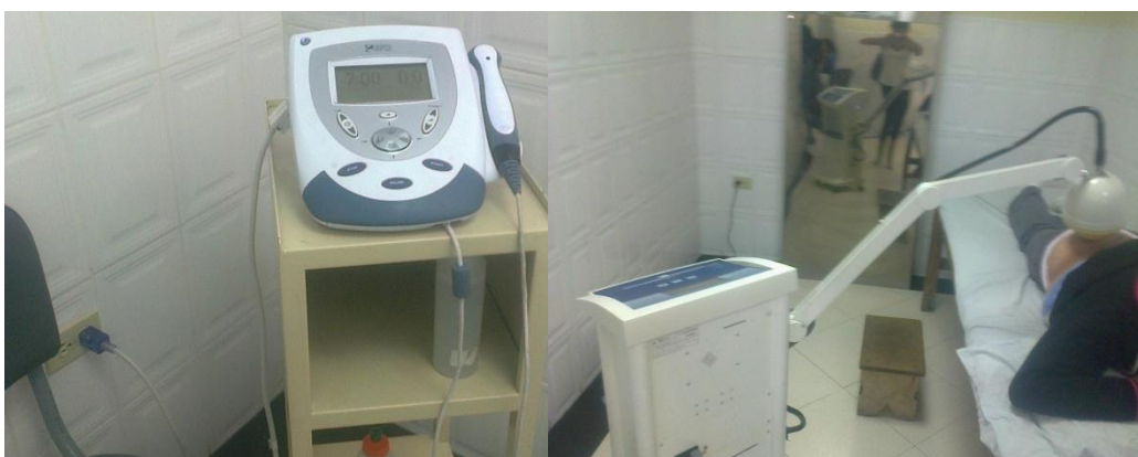
Equipos de electroterapia conectados directamente al tomacorriente, sin regulador.
