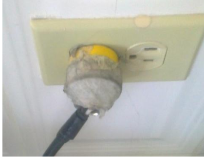
Cables de los equipos de electroterapia en mal estado.
