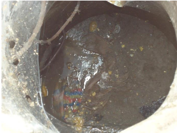
Acumulación de lodos, fundas en el interior del Pozos de revisión
