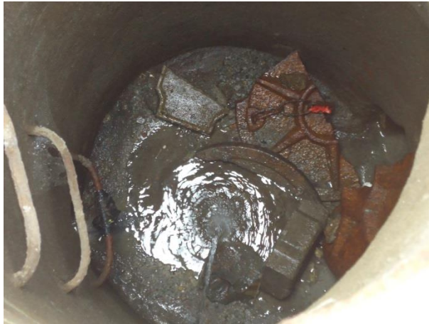
Pozos de revisión tapados por adoquines y una tapa H.F.
