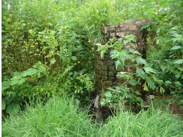
Mal estado del pozo de revisión
