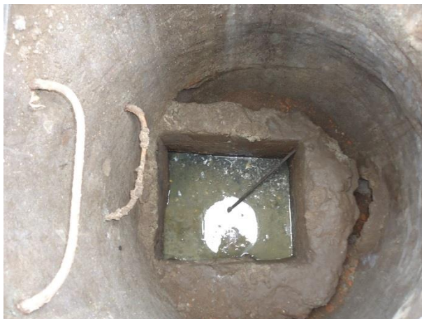
Pozos de revisión tapado con hormigón
