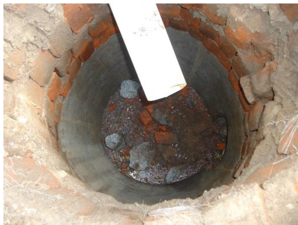
Tuberías salientes en los pozos de revisión y escombros
