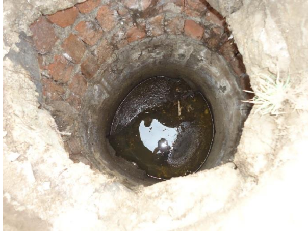
Pozos de revisión tapados por la falta de mantenimiento
