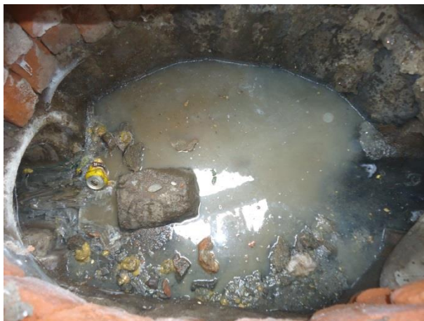
Pozos de revisión tapados por basuras acumuladas
