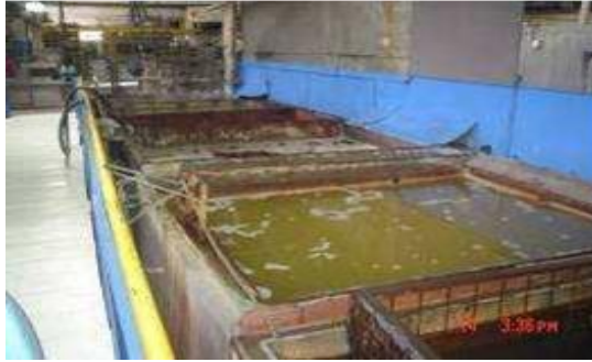
Figura 2-15: Cubas de Fosfatización Fuente: Valencia Alvaro.
